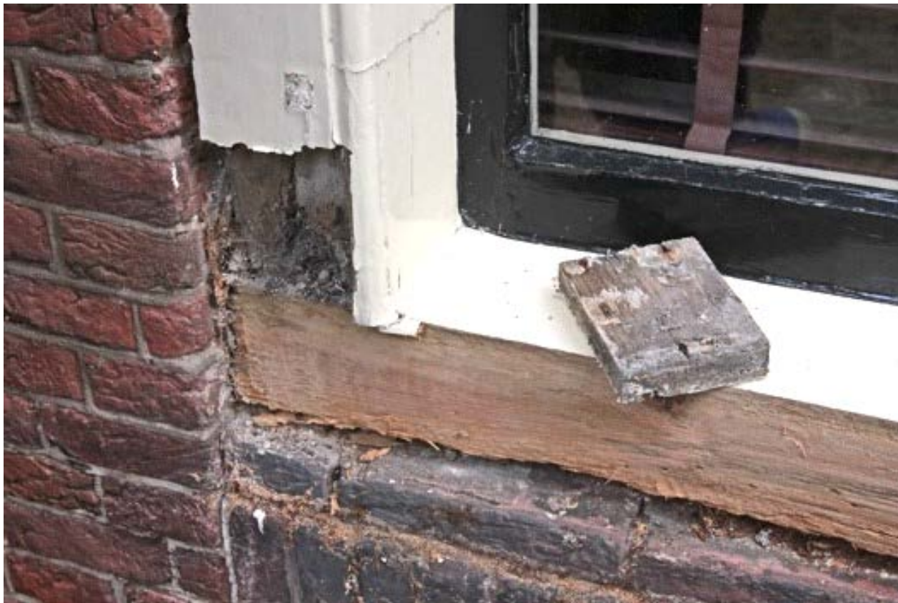
Schade aan het kozijn na ontmantelen blijkt veel groter dan opgenomen. Door tijdig rapporteren bespreekbaar maken van de wijze waarop gerepareerd of vernieuwd moet worden.
