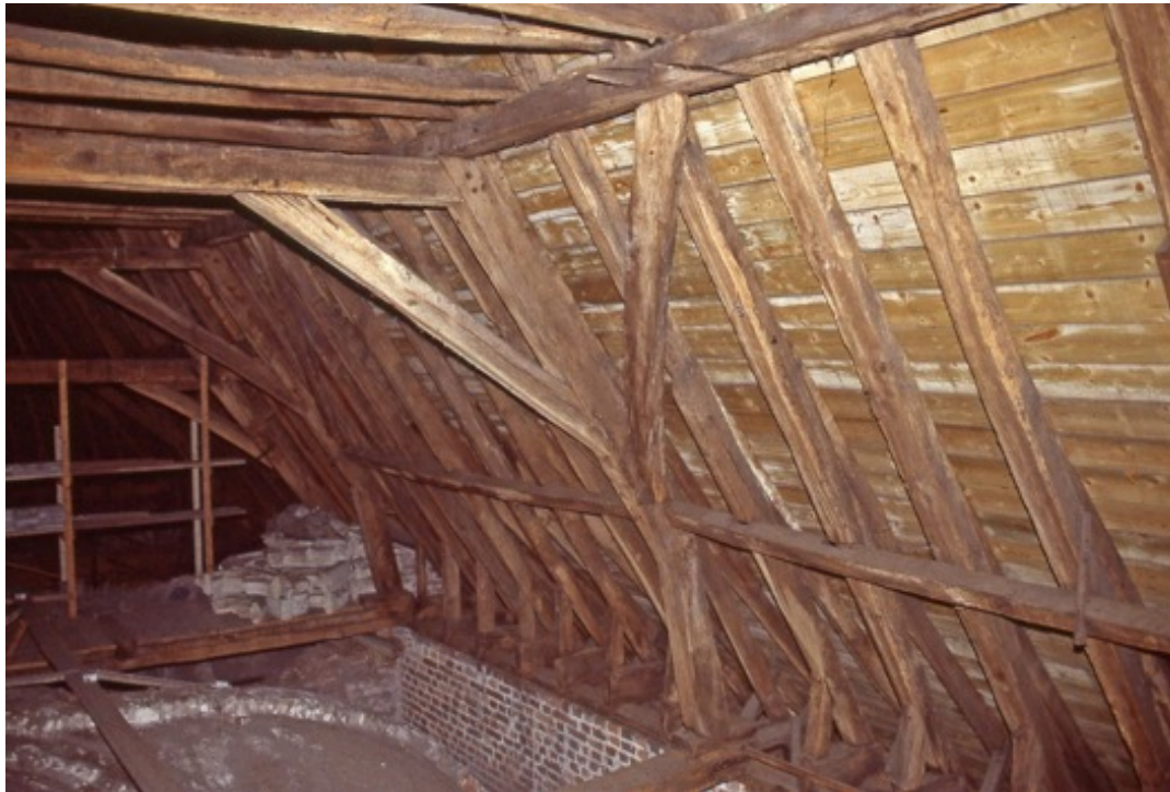
In het verleden gerestaureerde kap. Op het dakbeschot een witte uitslag van het inmiddels verboden bestrijdingsmiddel lindaan.
