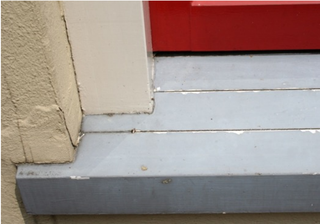
Een zware onderdorpel samengesteld met lichtere houtmaten met verticale lijmnaden. Dit is niet toegestaan. Een verticale lijmnaad mag alleen achter de glaslijn toegepast worden.
