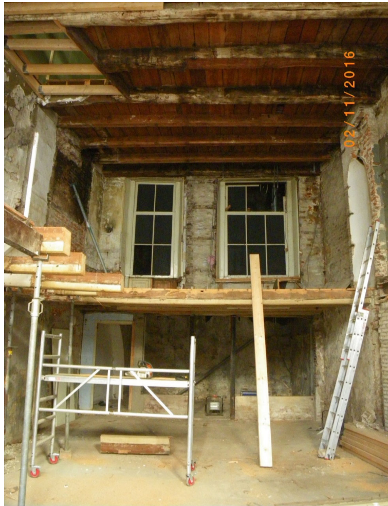
7 stuks moerbalken (ofwel dragende dwars balken waarop de vloer rust van muur tot muur) zijn vernield. Het betreft hier zware grenen balken uit 1756 van een enkelvoudige balklaag.
